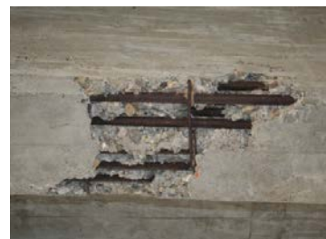
主桁の鉄筋露出
