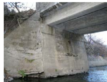
下部工基礎の洗掘
