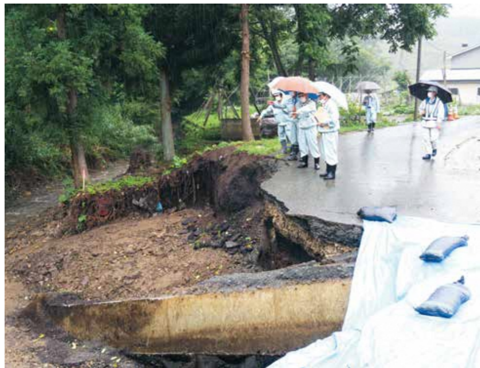
河川の増水により村道が決壊(瀬月内地区)
