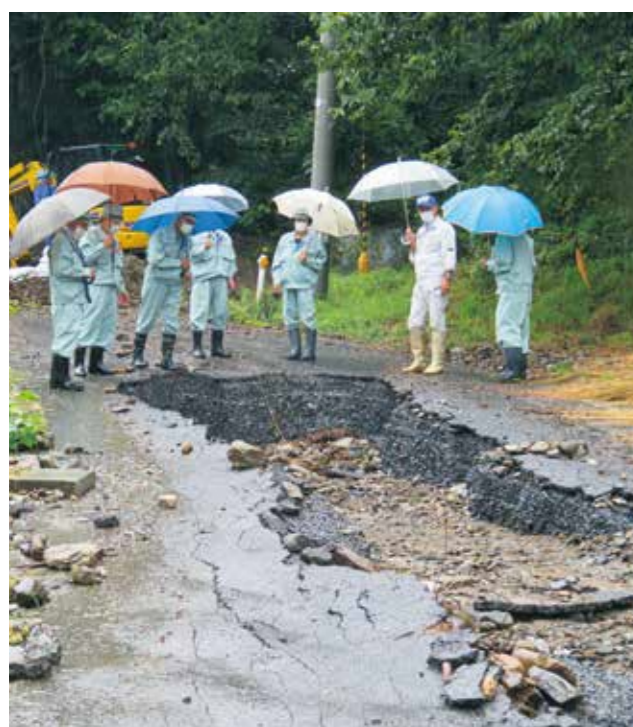
水路の氾濫により道路が陥没(平内地区)
