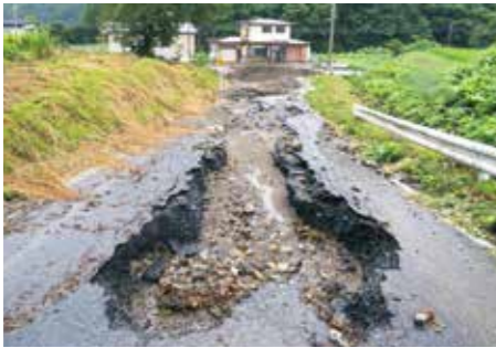
道路が削りとられた現場(平内地区)
