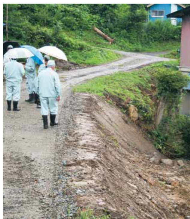
洪水により道路が崩壊(黒沢地区)
